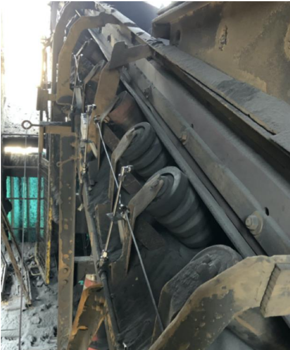
Correa transportadora con el cable sensor instalado
