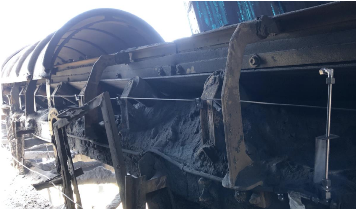
Cinta transportadora de cobre con cable sensor en el sitio de Ventanas
