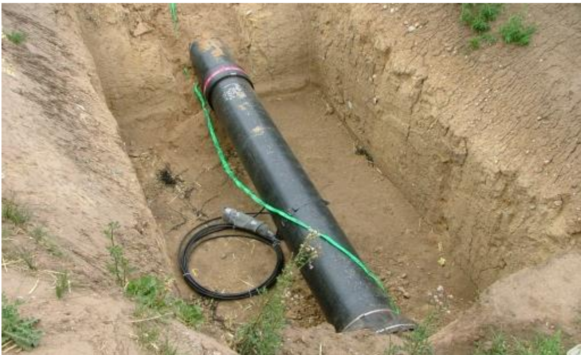
Rohrleitung mit Sensorkabel (schwarz)
