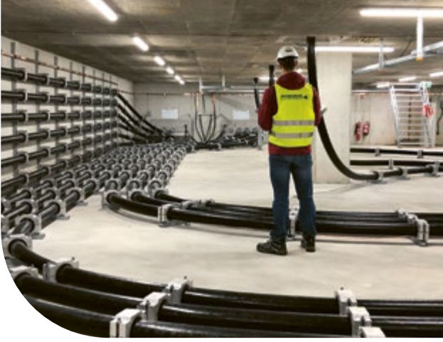
Temperatur-Monitoring einer 380kV -Leitung
