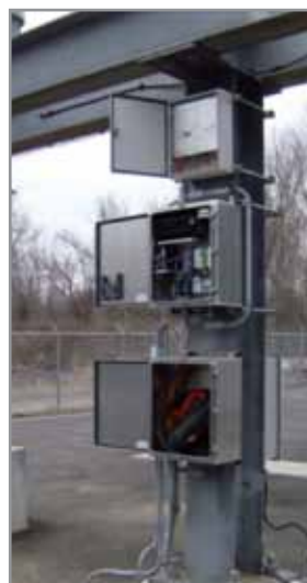
Installation en extérieur du poste
