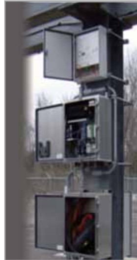
변전소 옥외 설치
