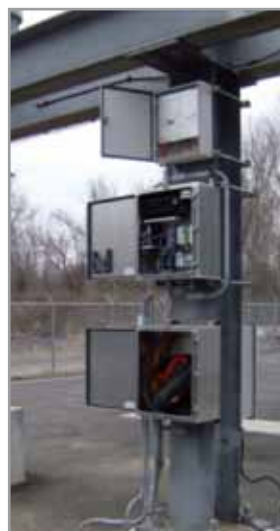
Instalação externa e subestação
