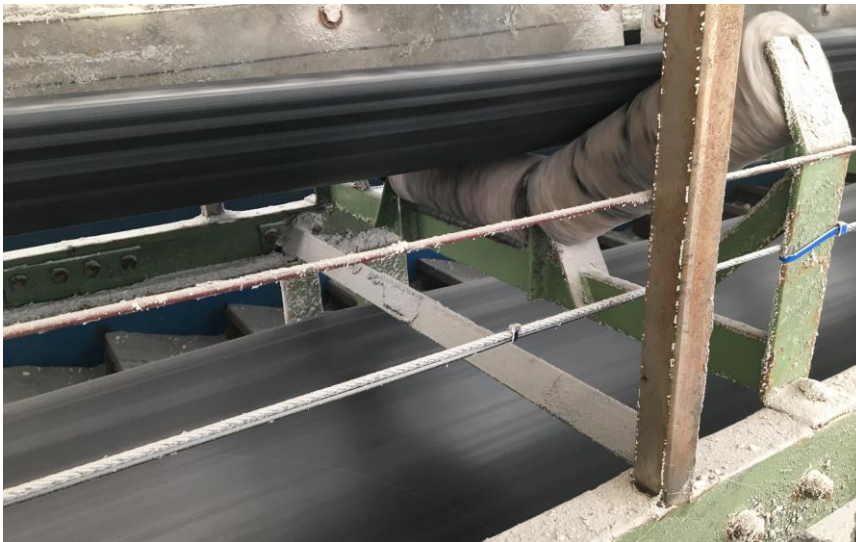
Installation Sensorkabel (schwarz), befestigt an einem Spanndraht
